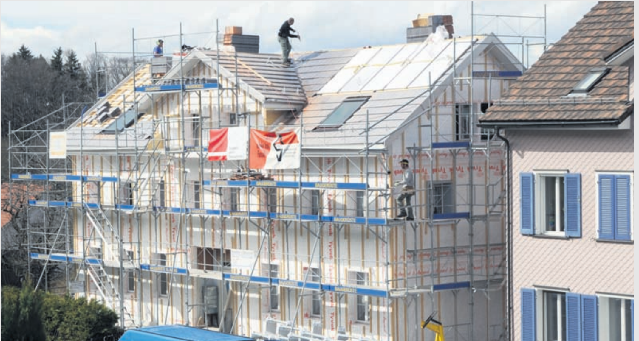
Ein Mehrfamilienhaus während der Sanierung. Gezielte Massnahmen führen zu einer beachtlichen Senkung des Energieverbrauches sowie zu mehr Komfort und einer Wertsteigerung des Gebäudes.
