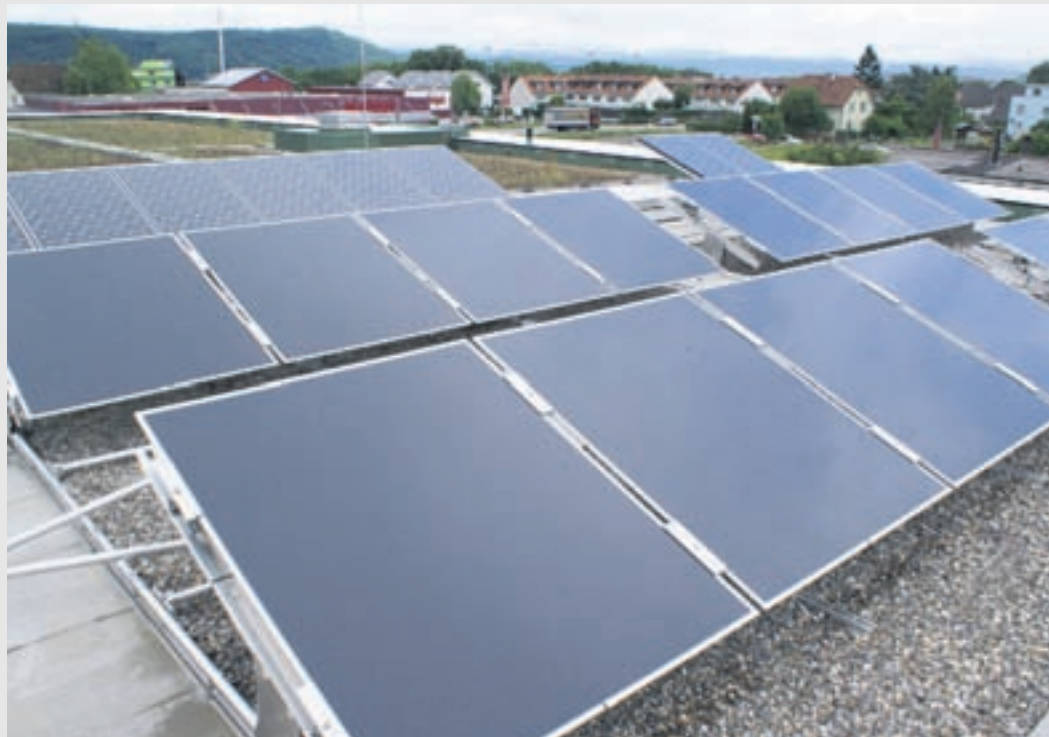
Fotovoltaik. Solarpanel für die Fotovoltaikanlage.
